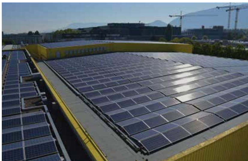
La dernière réalisation est installée sur le toit des Laiteries Réunies de Genève.
